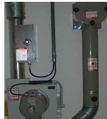
raccordement correct du petit appareil de ventilation et du réchauffeur d'air
