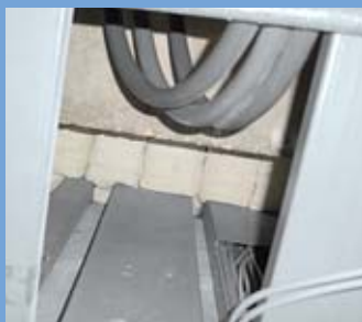
Barriera antifiama con cuscini di amianto
