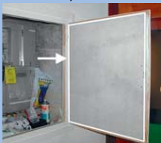
Pannello antincendio contenente amianto
