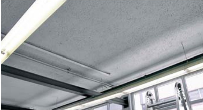
Rivestimento del soffitto in amianto spruzzato
