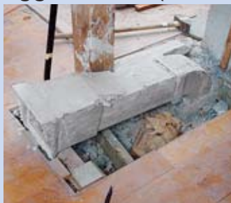
Canale di ventilazione in fibrocemento
