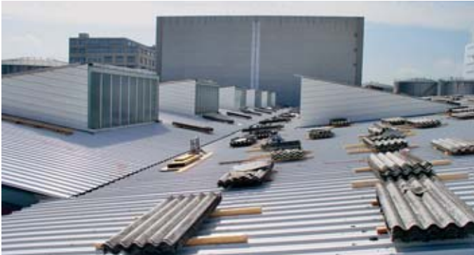
Lastre ondulate contenenti amianto
