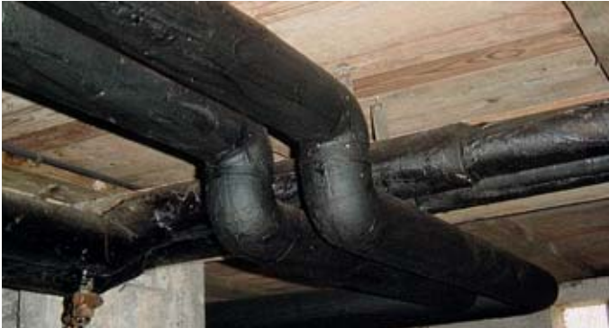
Guaina bituminosa contenente amianto
