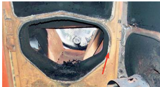
Cordone di amianto
