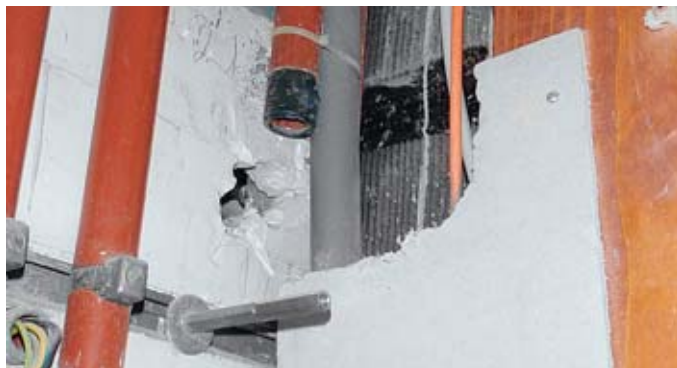
Pannello antincendio in una colonna montante
