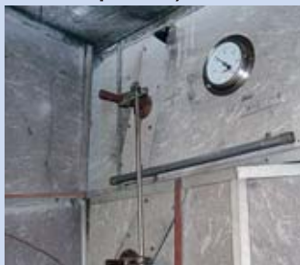
Impianto di ventilazione in fibrocemento
