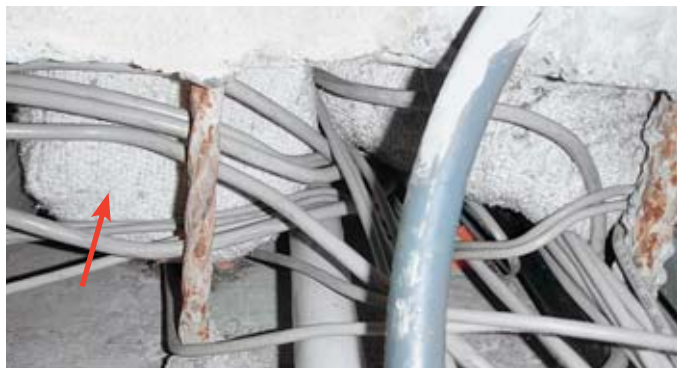
Barriere antifiamma contenenti amianto
