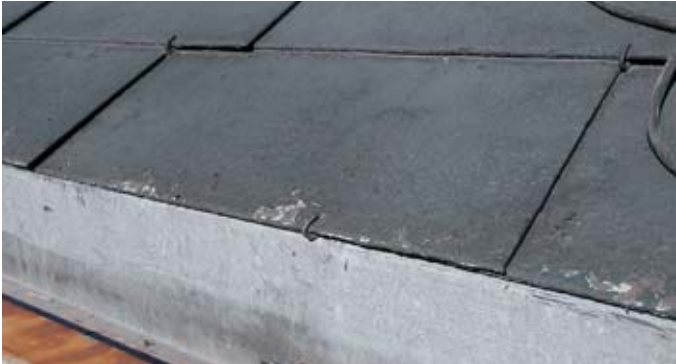
Pannelli di ardesia contenenti amianto
