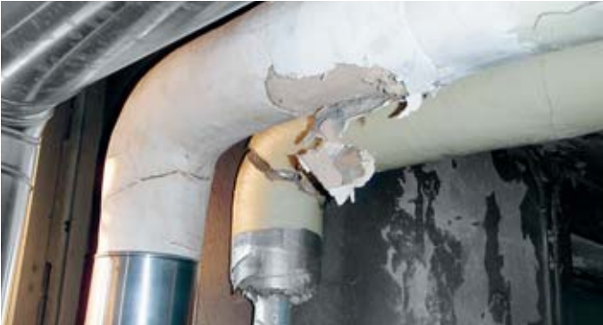
Tubo con malta contenente amianto
