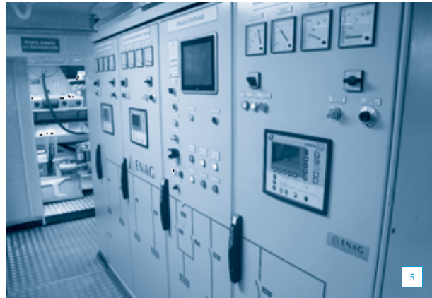
5 Vevey, 1907, remis en service en 2013: une motorisation ultra moderne. Photo: © Yves de Siebenthal.
