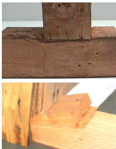
Fig.16 : Les étais enfoncés dans la traverse ou dans la sous-poutre de tête indiquent une mise à contribution excessive du système d'étagage (Federal Emergency Management Agency – FEMA)
