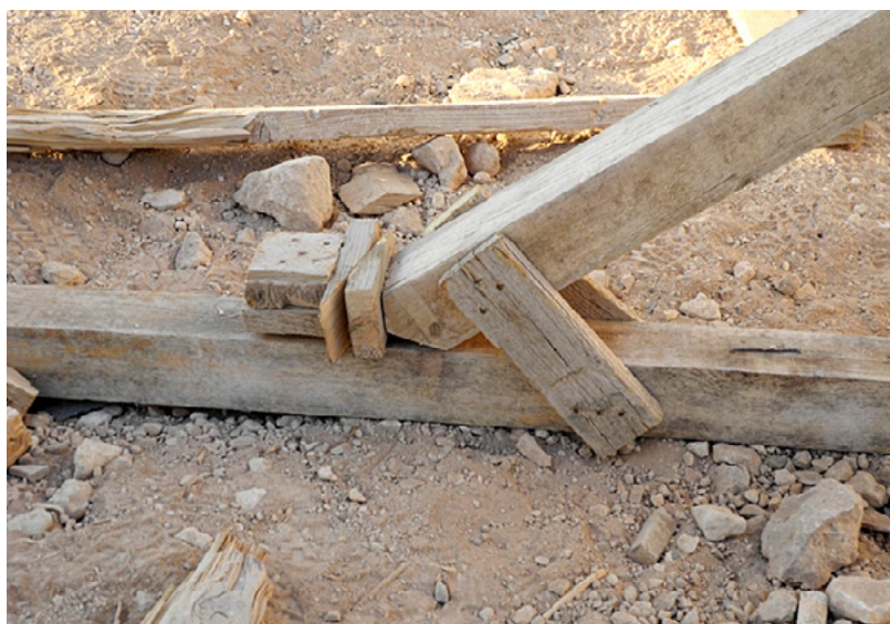
Fig.110 : Assurage insuffisant de la contrefiche sur la solive (Regina Wenk)
