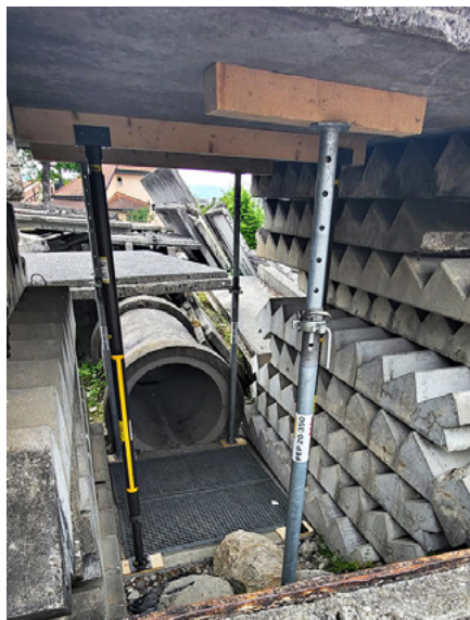
Fig.47 : Étai isolé du secteur du sauvetage (Paratech)
