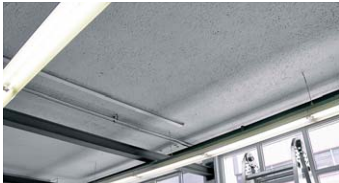
Revêtement d'amiante floqué au plafond
