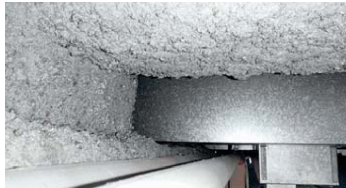
Amiante floqué comme protection incendie sur une poutre métallique
