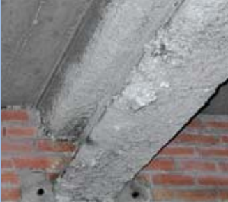
Isolation en amiante floqué
