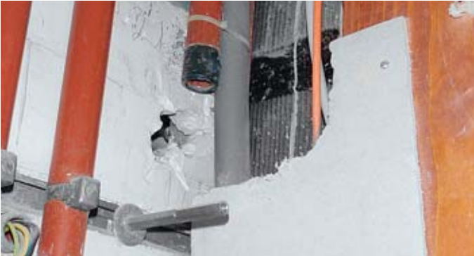
Panneau coupe-feu dans un puits d'accès
