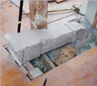
Canal de ventilation en fibrociment
