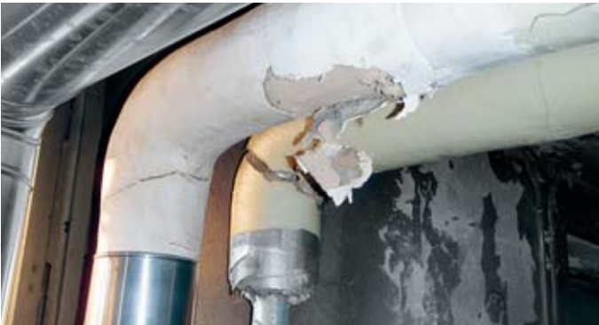
Tuyau avec mortier amianté
