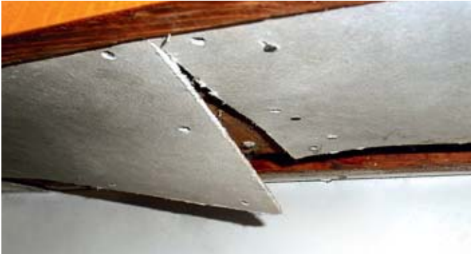
Panneaux légers amiantés comme protection anti-feu
