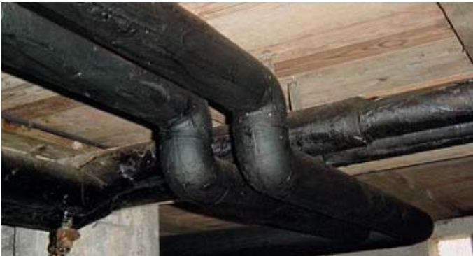
Revêtement bitumineux amianté
