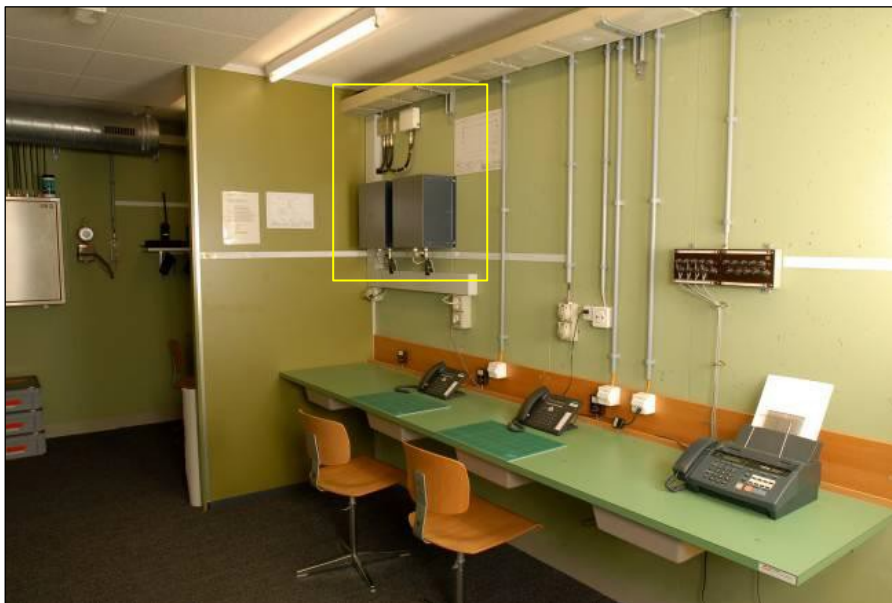
Fig. 11 Centre télématique, emplacement possible pour répéteur et répartiteur de fréquences
