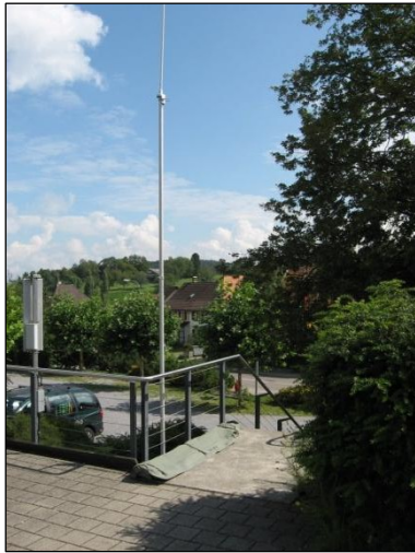
Fig. 3 Antenne SEA 400 S à côté d'une antenne directionnelle
