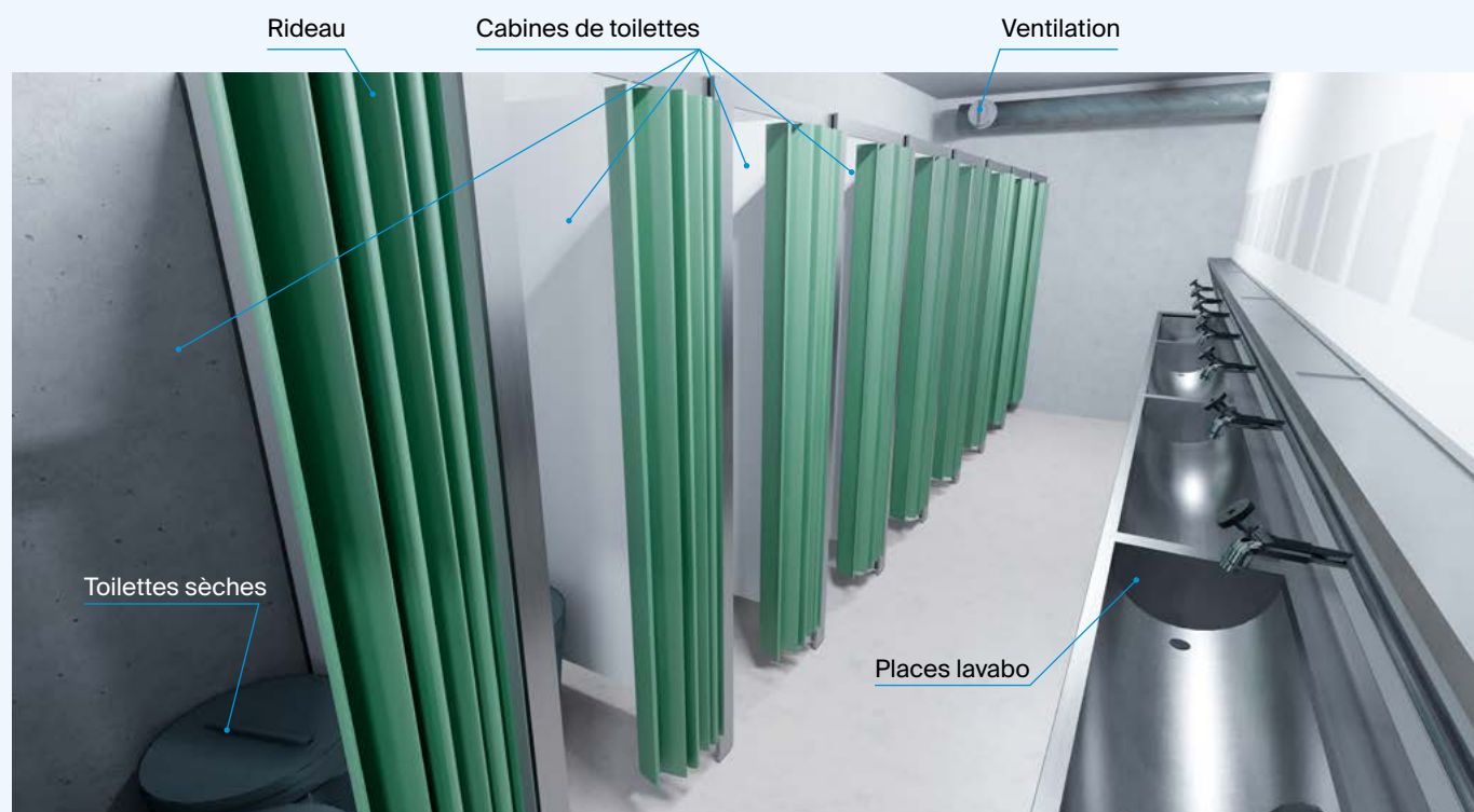
Fig. 5 Depuis 1987, les abris doivent être équipés de toilettes sèches installées dans des cabines munies de portes ou rideaux. L'OFPP recommande de compléter l'équipement des abris plus anciens.
