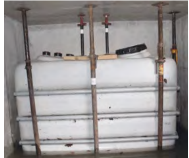
Abb. 83: Sicherung eines Heizöltanks (Gebäudeversicherung Bern GVB)
