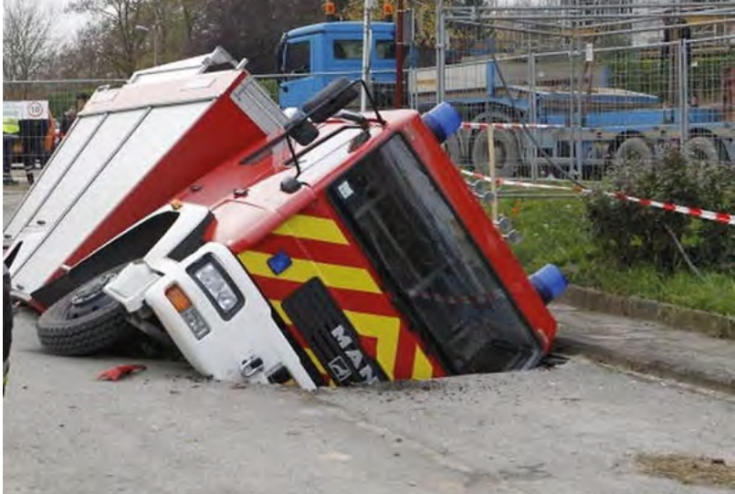
Abb. 19: Fahrzeugeinsturz wegen unterspülter Strasse (Luxemburger Wort)
