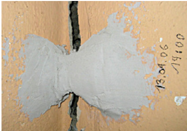
Abb. 18: Gipsiegel über einem Riss
