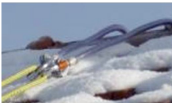
Verankerung am Dachfirst
