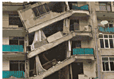
Abb.4: Ausgefallene / überlastete Auflager
