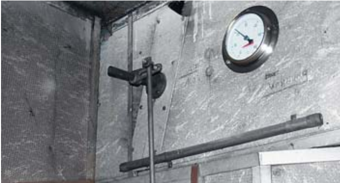
Lüftungskanal aus Asbestzementplatten
