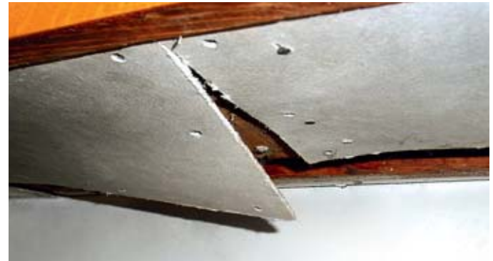
Asbesthaltige Leichtbauplatten als Brandschutz
