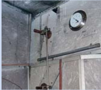
Lüftungsanlage aus Asbestzement
