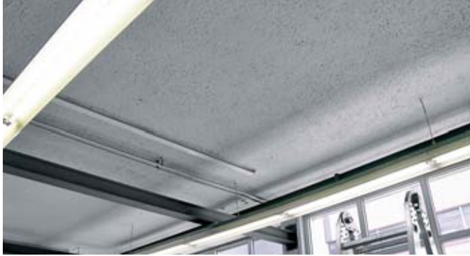
Spritzasbestbelag an Decke
