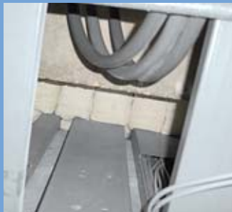
Brandabschottung mit Asbestkissen
