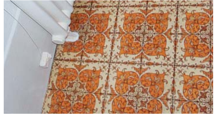
Typisches Muster eines mehrschichtigen asbesthaltigen Bodenbelags
