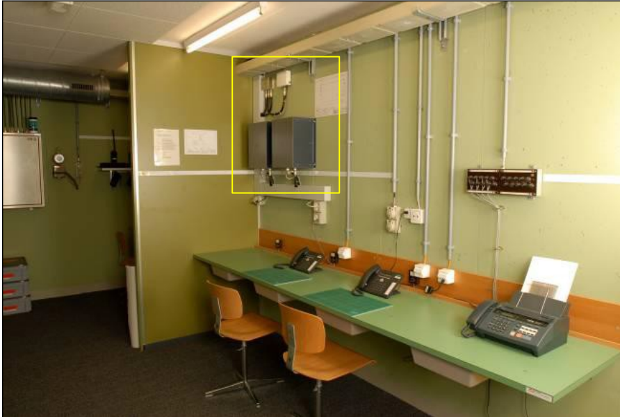
Abb. 11 Telematikzentrum, möglicher Stao Repeater und Frequenzweiche
