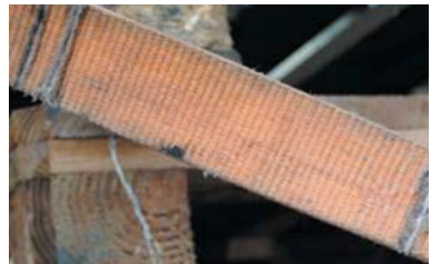
Abb.31: Beschädigter Gurt (Beispiel)
