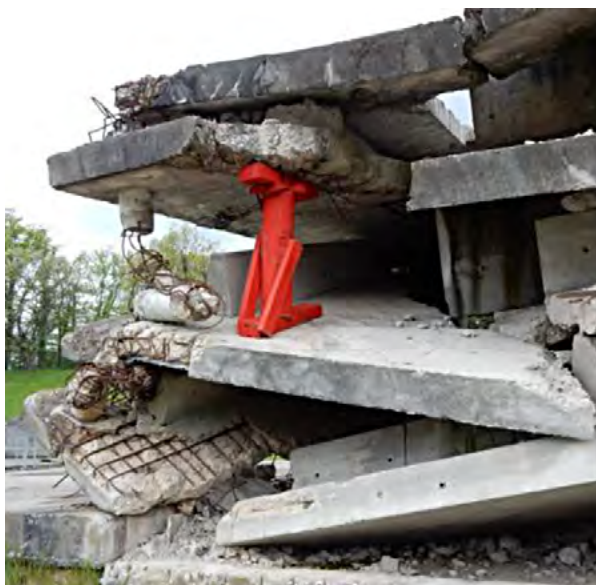
Abb. 49: Sehr gefährliche und unbrauchbare Abstützung einer auskragenden Deckenplatte (Rettungskette Schweiz)
