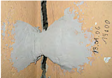
Abb.18: Gipsiegel über einem Riss
