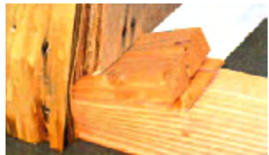
Abb. 16: In die Schwelle- oder den Unterzug eingedrückte Stützen zeigen eine Überlastung des Abstützsystems an (FEMA)
