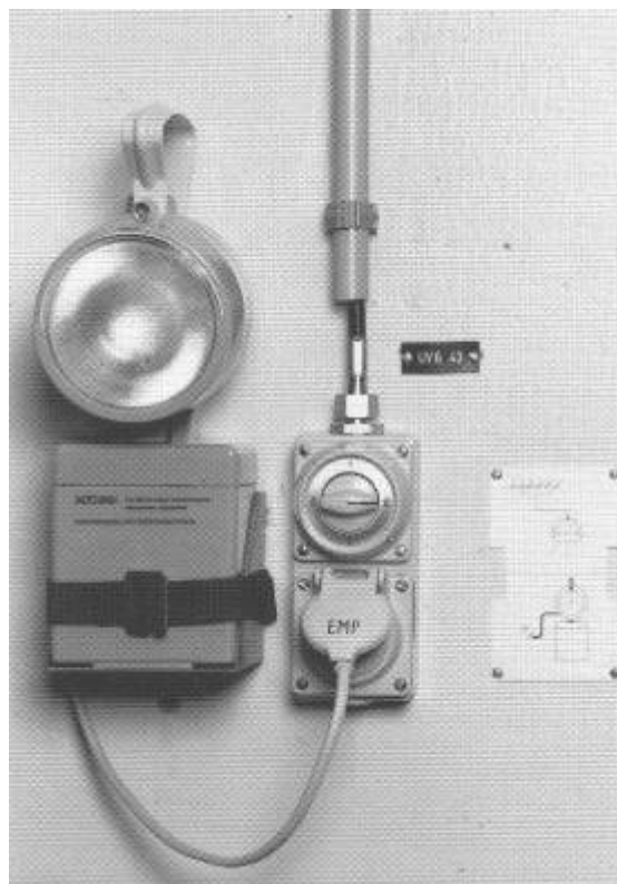
Figur 75 Kombination Schalter Steckdose für EMP-geschützte Energieverbraucher (Steckdose für Nothandleuchte, Schal- ter für Operationsleuchte)
