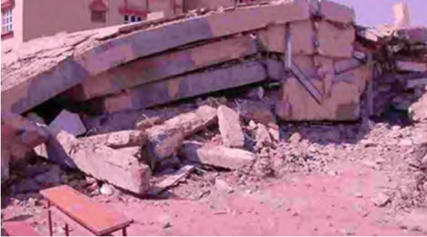
Abb.17: Totaler Einsturz nach einem Erdbeben (Hans Hausammann)
