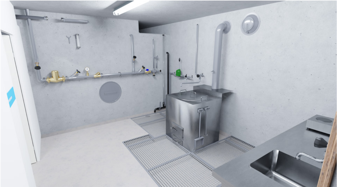
▲ Grosse Schutzräume verfügen über eine erweiterte Ausstattung, zum Beispiel eine Küche. © BABS
