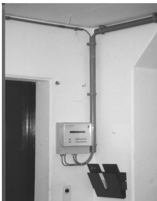
Centrale di misurazione e d'allarme con porta documenti installata nel locale degli attrezzi
