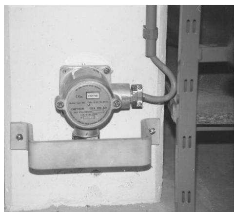
Esempi di rivelatori di gas Ex installati nel locale degli attrezzi (con staffa di protezione)
