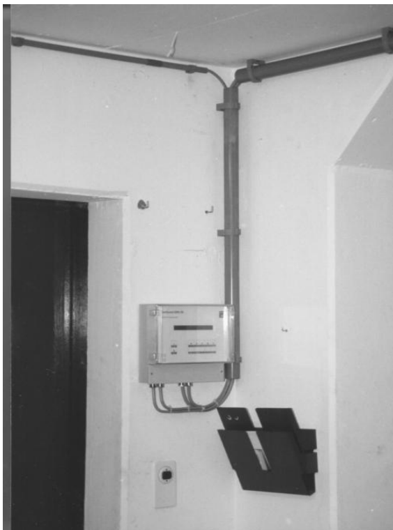
Mess- und Alarmzentrale im Geräteraum installiert mit Dokumentenhalterung
